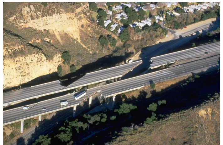
Pont autoroutier effondré
